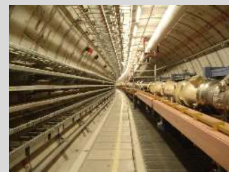
Fig. 1.19 – Tunnel du collisionneur HERA.
